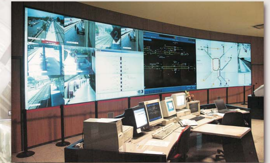
SISTEMAS FLEXIBLES QUE GARANTIZAN ACTUALIZACIONES POSTERIORES FLEXIBLE SYSTEMS THAT ALLOW FUTURE UPGRADES
